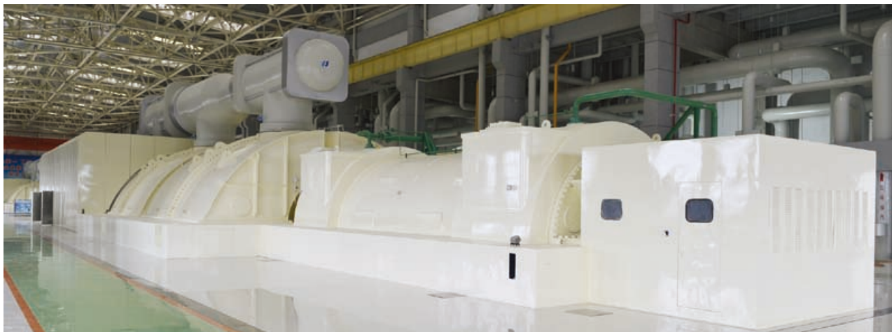
十里泉电厂9号机组运转层
